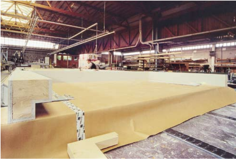
◀ Ein hoher Vorfertigungsgrad war gefragt: das Kapseln der Wandelemente in der Werkstatt in Bachmehring
