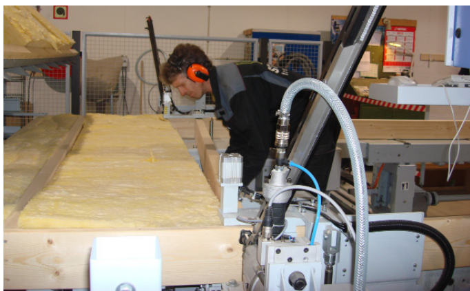
Закладка утеплителя в каркасной станции | Installation of insulation at the framing station
